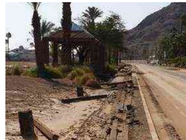
פיתוח מותאם לתוואי זרימת הנגר העילי בטיילת החופית - טיילת אהרן נסן לאחר סערה ראשונה, נובמבר 2020
